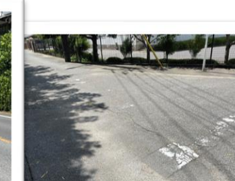
停止線が消えている市道
